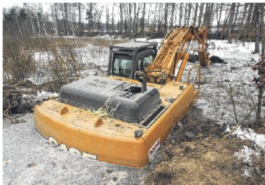
Nichts geht mehr: Der Raupenbagger ist halb eingesunken.
